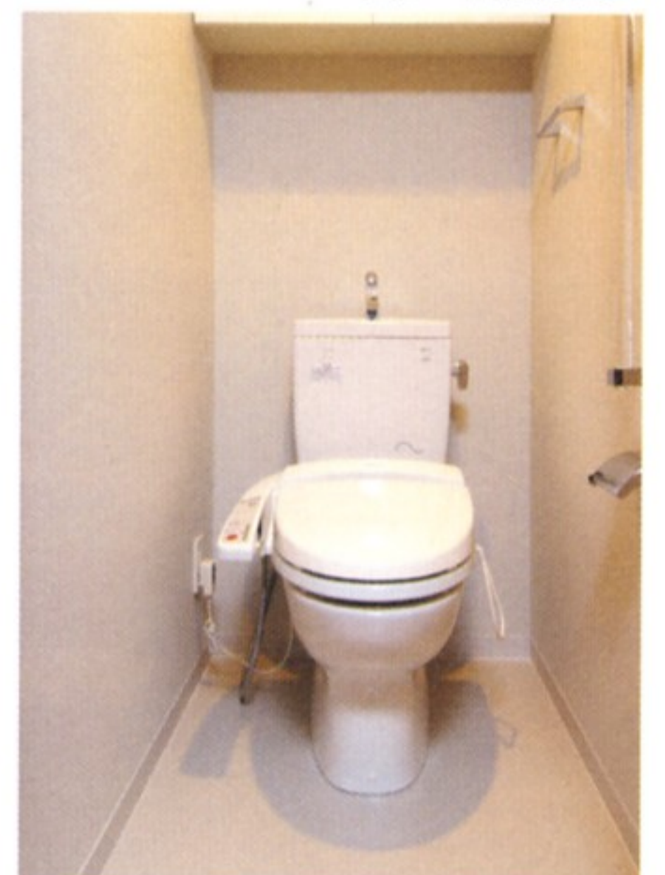
温水洗浄暖房便座付トイレ
