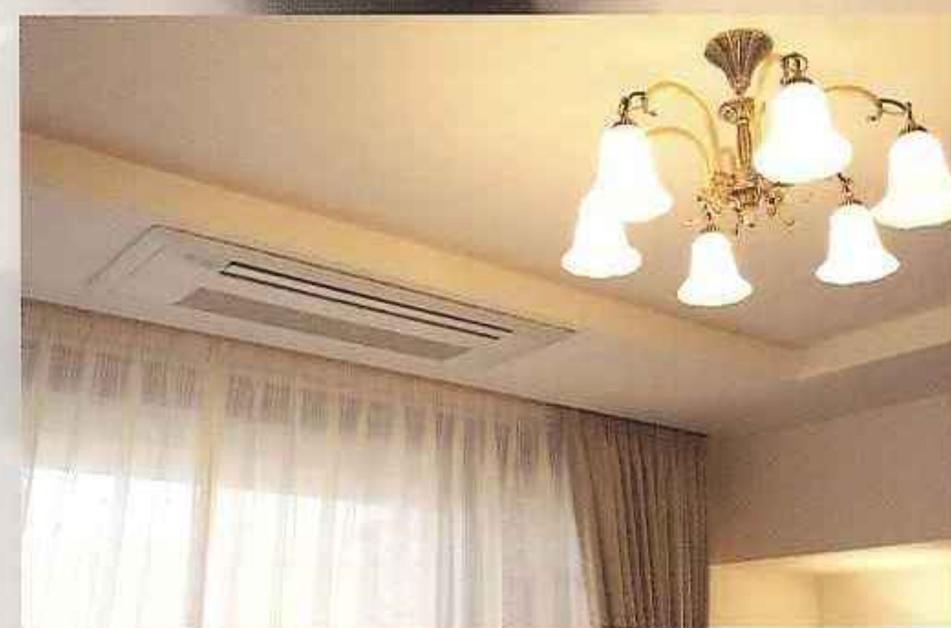
天井カセットエアコン&折上天井
