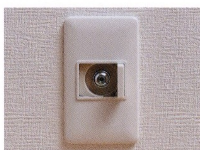
【ガスコンセント】
